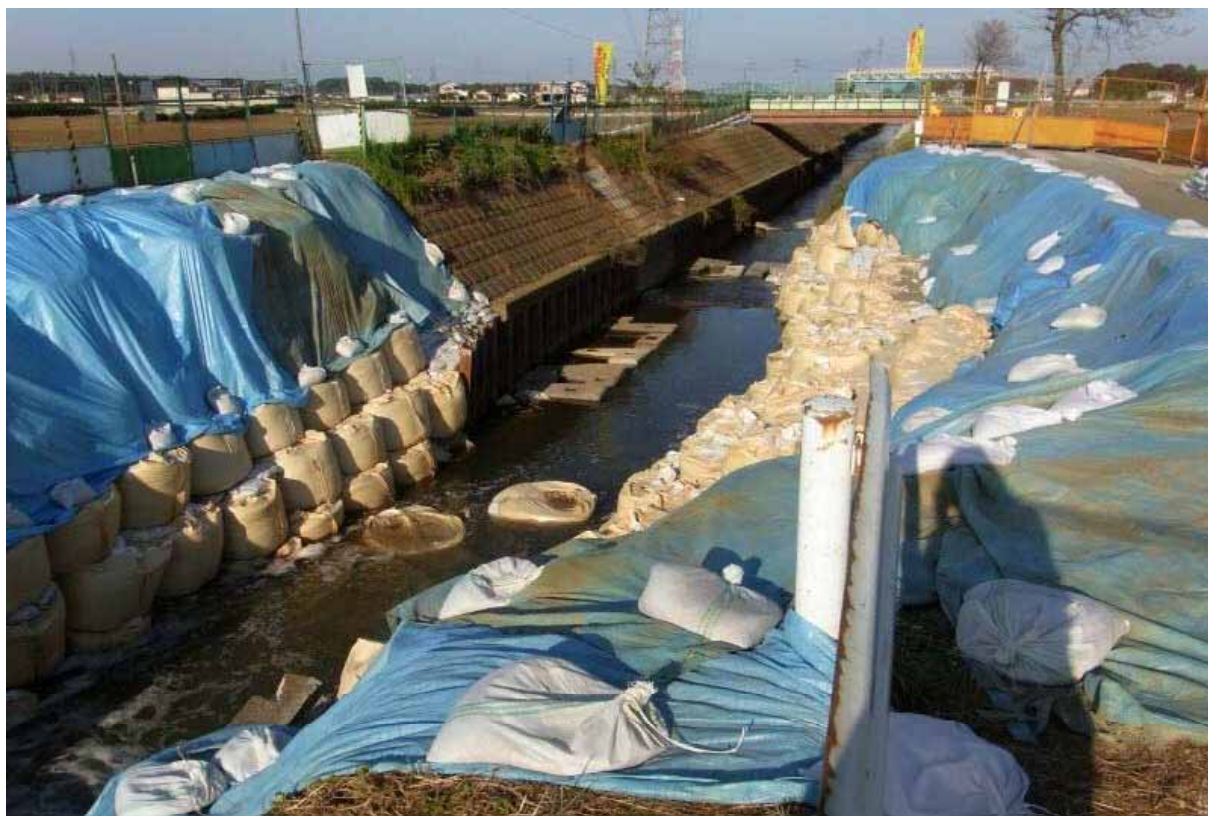
護岸が削られ、通学路の橋崩壊 狭山市堀兼地区 2009年10月
